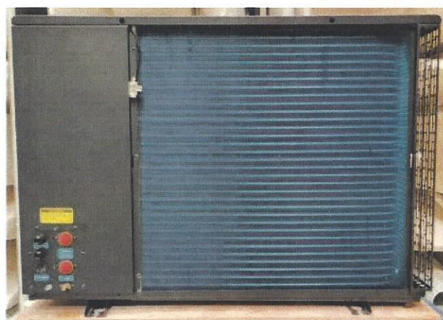
Picture 2 Pompa ciepła: widok z tyłu
